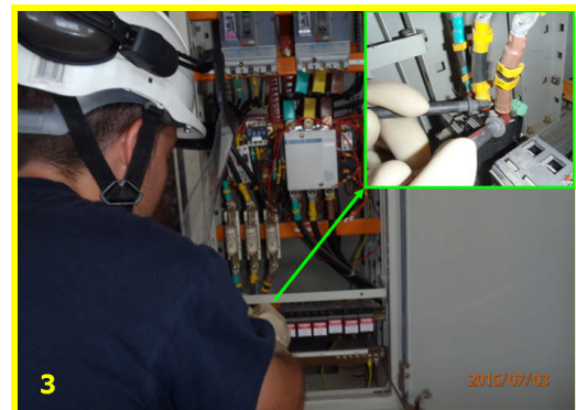
3. Testing valvetrab continuity in A compartment simulation 3. Simulación medición continuidad valvetrab en compartimento A
